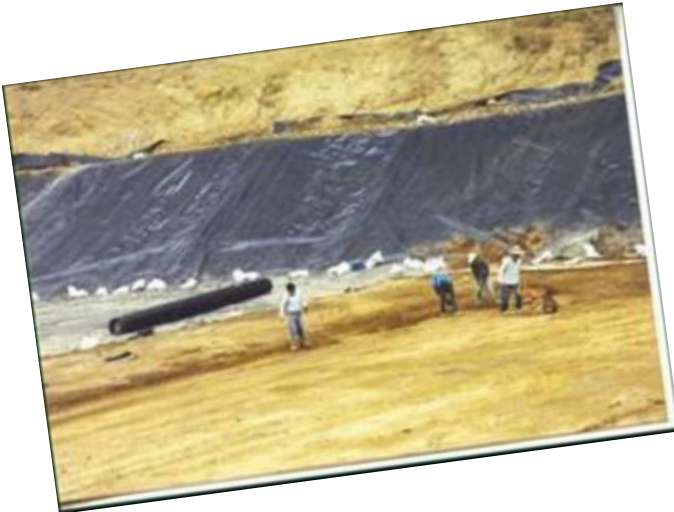
Sistema de impermeabilización con geomembranas
