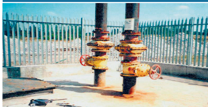
Figura 2.4 Conductos de ventilación del gas en un pozo de mina abandonado (Reino Unido)
